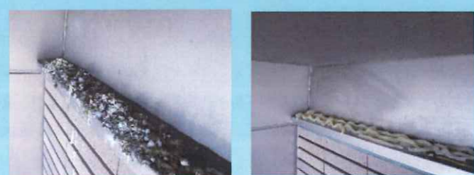
軒下の鳩ふんによる被害。ハト対策にはネット貼りや、スパイク(ピン設置)などありますが、とまる場所へ薬剤を塗布する工法もあります。こちらの店舗様は塗布後3年はハトによる被害がなくなりました。
