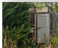
雑草の根が槽内に侵入するリスクが！！
