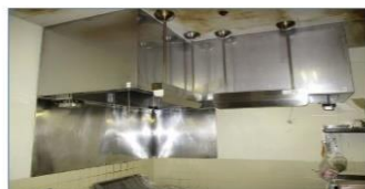
レンジフード 清掃後
