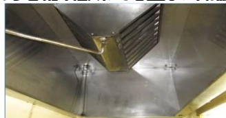
レンジフード 清掃後
