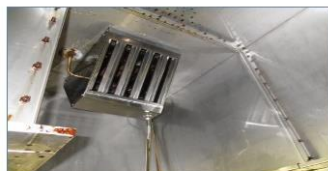
レンジフード 清掃後
